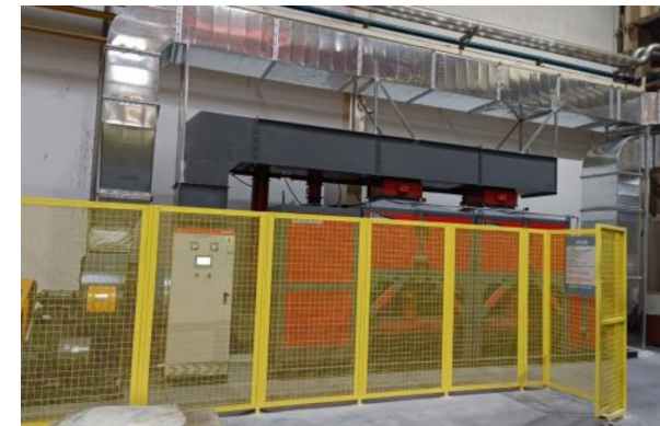
废气处理设施
